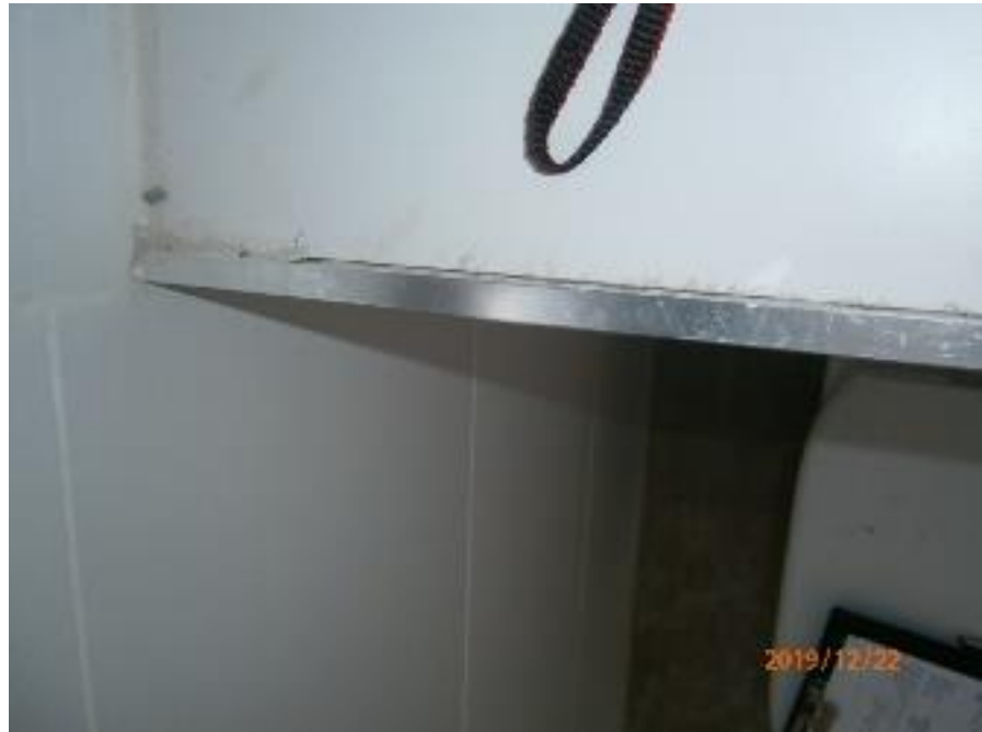
זאת בניגוד לת"י 1555 חלק 3 (מערכת פסיפס ואריחי קרמיקה לריצוף ולחיפוי בבניינים: ריצוף, 2012) סעיף 3.1, ציטוט:
