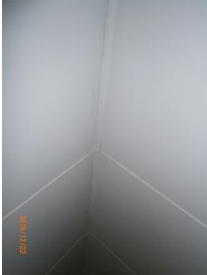
זאת בניגוד לת"י 1555 חלק 3 (מערכת פסיפס ואריחי קרמיקה לריצוף ולחיפוי בבניינים: ריצוף 2012) סעיף 3.1, ציטוט:
